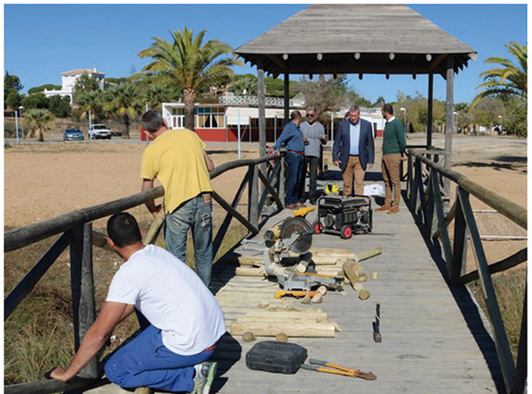
El Ayuntamiento puso en marcha un Plan Integral de Reparación y Recuperación de la Ribera con actuaciones en el embarcadero, las pasarelas, el parque infantil, los accesos, etc.
