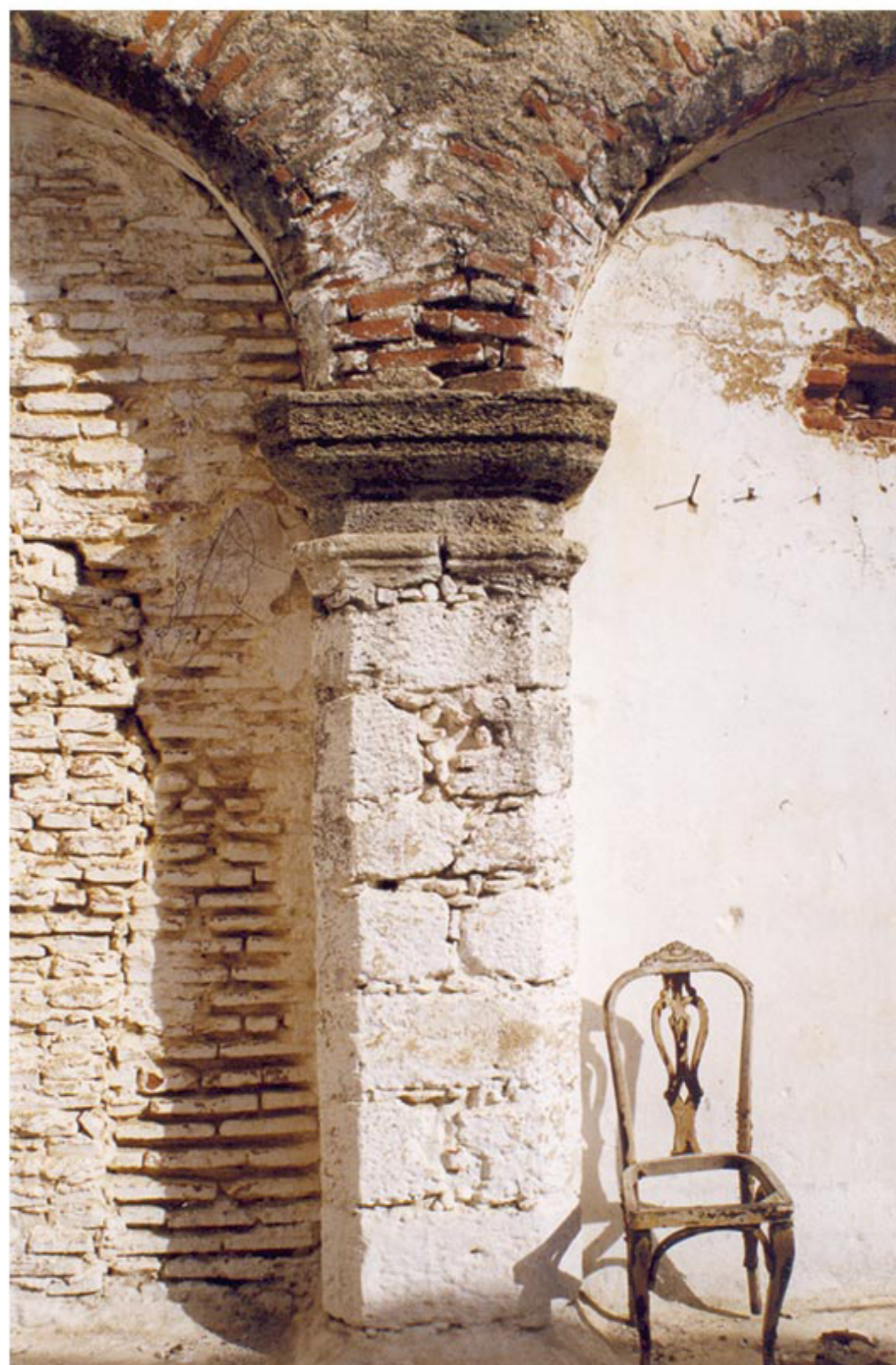
Detalle de la galería Este cegada por una casa añadida hacia 1920.
