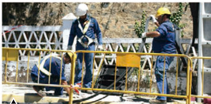
Finalizaron los trabajos para garantizar la calidad del suministro eléctrico en El Rompido. Tras numerosas gestiones municipales, Endesa acometió las obras de renovación, culminando los trabajos iniciados el verano pasado, cuyo objetivo es que no se repitan los cortes en el núcleo costero.
