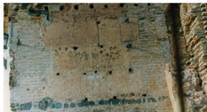
Simulación de sillares en la torre de la puerta antes de ser restaurada.
